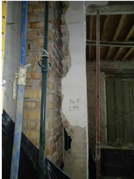
Figura 42. Rotura de muros de carga y pilastra de ladrillo provocada por la rehabilitación del edificio colindante.
