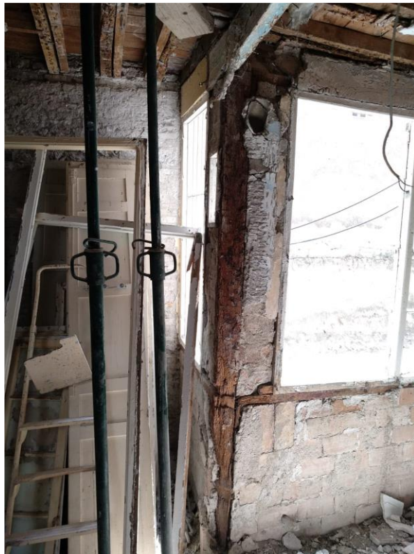
Figura 46. Pudrición y ataque por insectos en pilares y forjados de madera.
