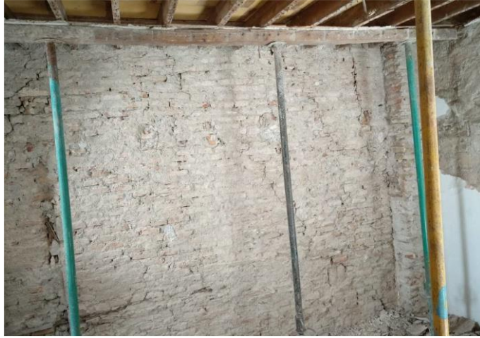
Figura 40. Fisuras y grietas en muros de carga por asentos en cimentación.
