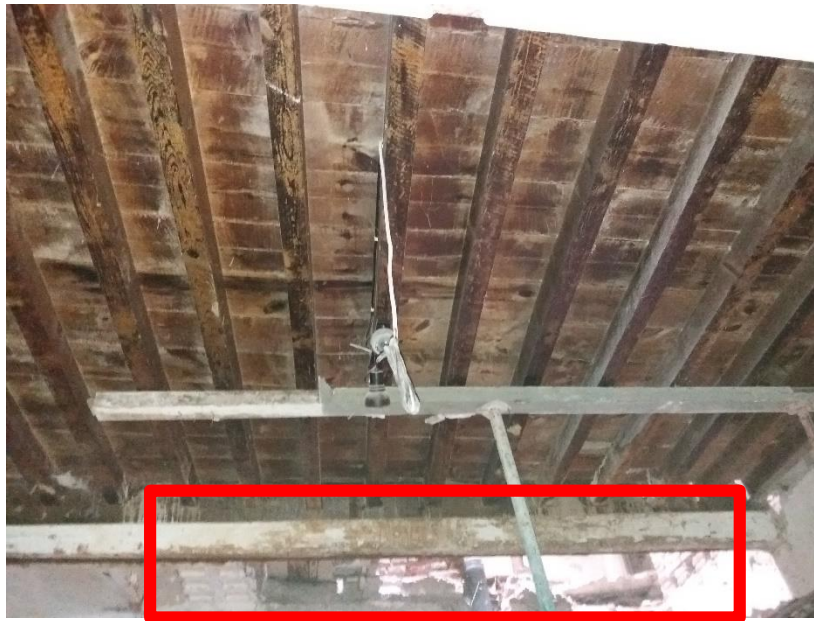
Figura 51. Imagen de la rotura del muro medianero. forjado zona 2.
