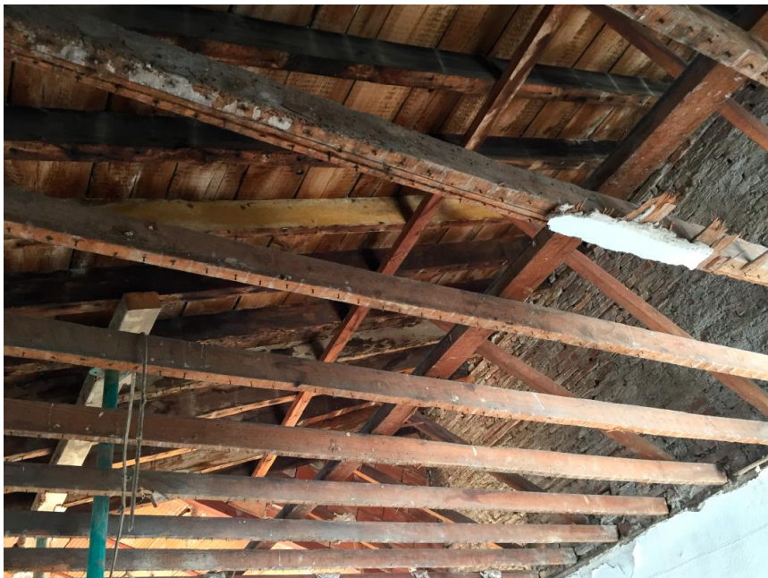
Figura 47. Estado de la cubierta de madera.
