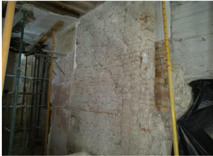
Figura 41. Rotura y fisuración de los muros de carga debido a la intervención en edificio medianero.
