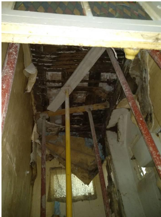
Figura 44. Forjado muy dañado por pudrición: pérdida total de la capacidad portante de las vigas.
