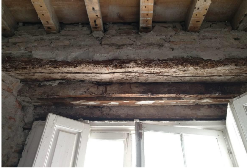
Figura 45. Estado general de los cargaderos. Ataque por insectos y pudrición en los apoyos.
